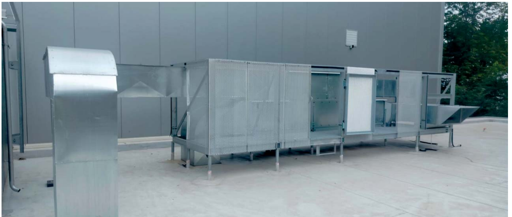
Vzduchotechnická jednotka na střeše sportovní haly.
