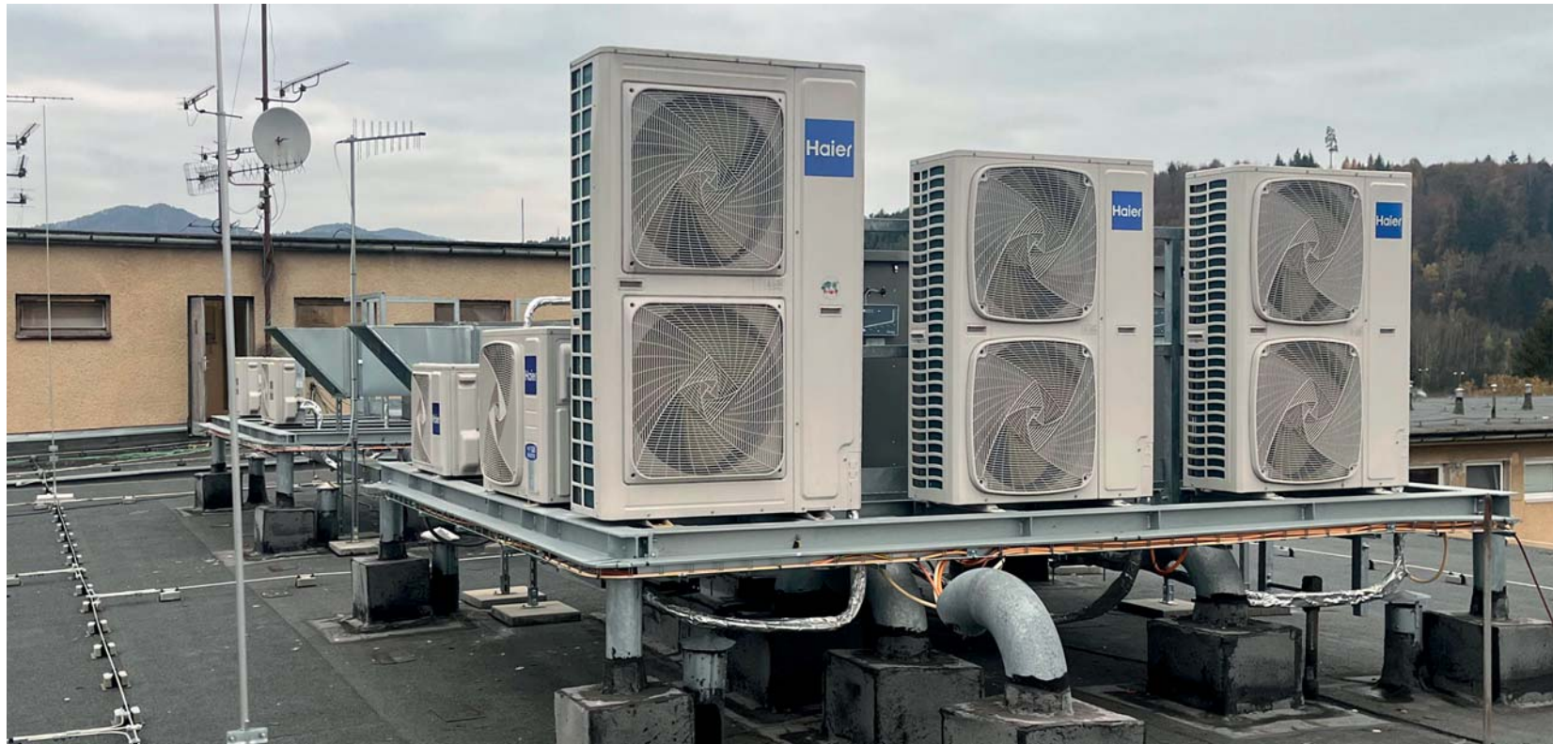
Strecha nemocnice - pohľad na kondenzačné jednotky.
