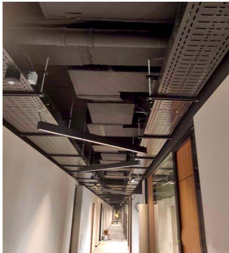
Strop v priestoroch chodby - pohľad na vnútorné klimatizačné jednotky.
